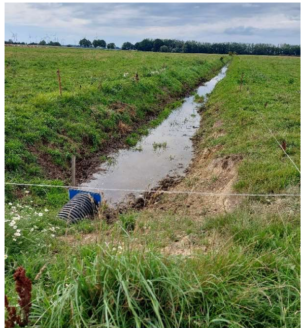
Abbildung 22 Polder Rosenhagen, Geschlossener Durchlass für Probestau, Wassermenge im Graben unzureichend, 25.08.2023
